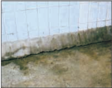
图474 正确清洗/消毒是不可能的，墙壁与地板之间的裂缝
