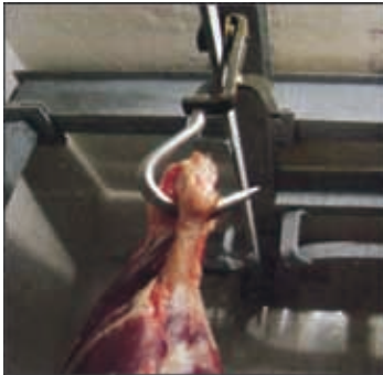
图 481 冷藏间器材充足：架空 镀锌横杆和横梁，不锈钢肉钩
