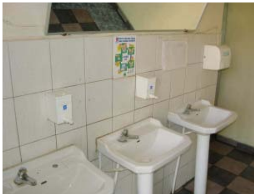
Figura 5. Unidad sanitaria para el lavado de manos.
