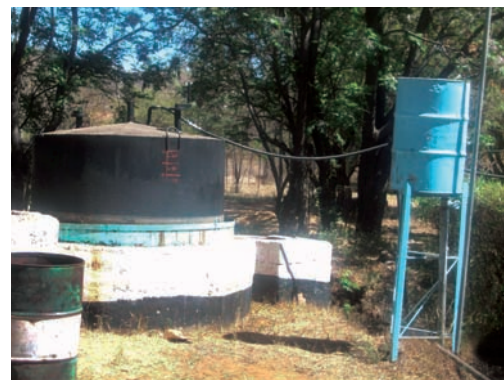
Le réservoir de collecte des gaz s'appuie sur un digesteur construit en béton. Les tuyaux / tubes au sommet du réservoir de gaz approvisionnent la maison avec du gaz méthane, au Botswana. (Reuben Sebegu)
