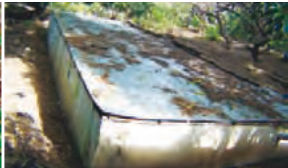
Estanque de hormigón para almacenamiento primario en la captación del yacimiento y derivación para pequeño riego. Note que la tapa evita que la basura contamine el agua y cause problemas de taponamiento o contaminación. Foto: José Cristóbal Escobar Betancourt.
