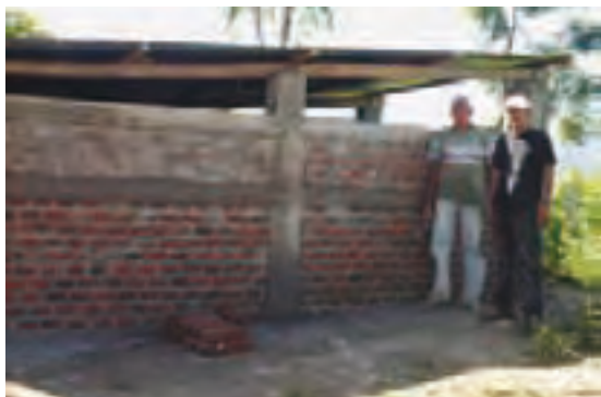
Estanque rectangular construido con ladrillos y hormigón para almacenamiento de agua derivada de yacimientos y cursos de agua efímeros para uso en riego. El techo puede servir como área de captación. Foto: Gilberto Herrera.
