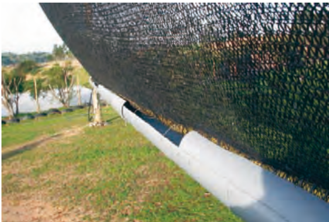
FIGURA 16-II: Disposición de la canaleta debajo del panel con la malla atrapaniebla.
