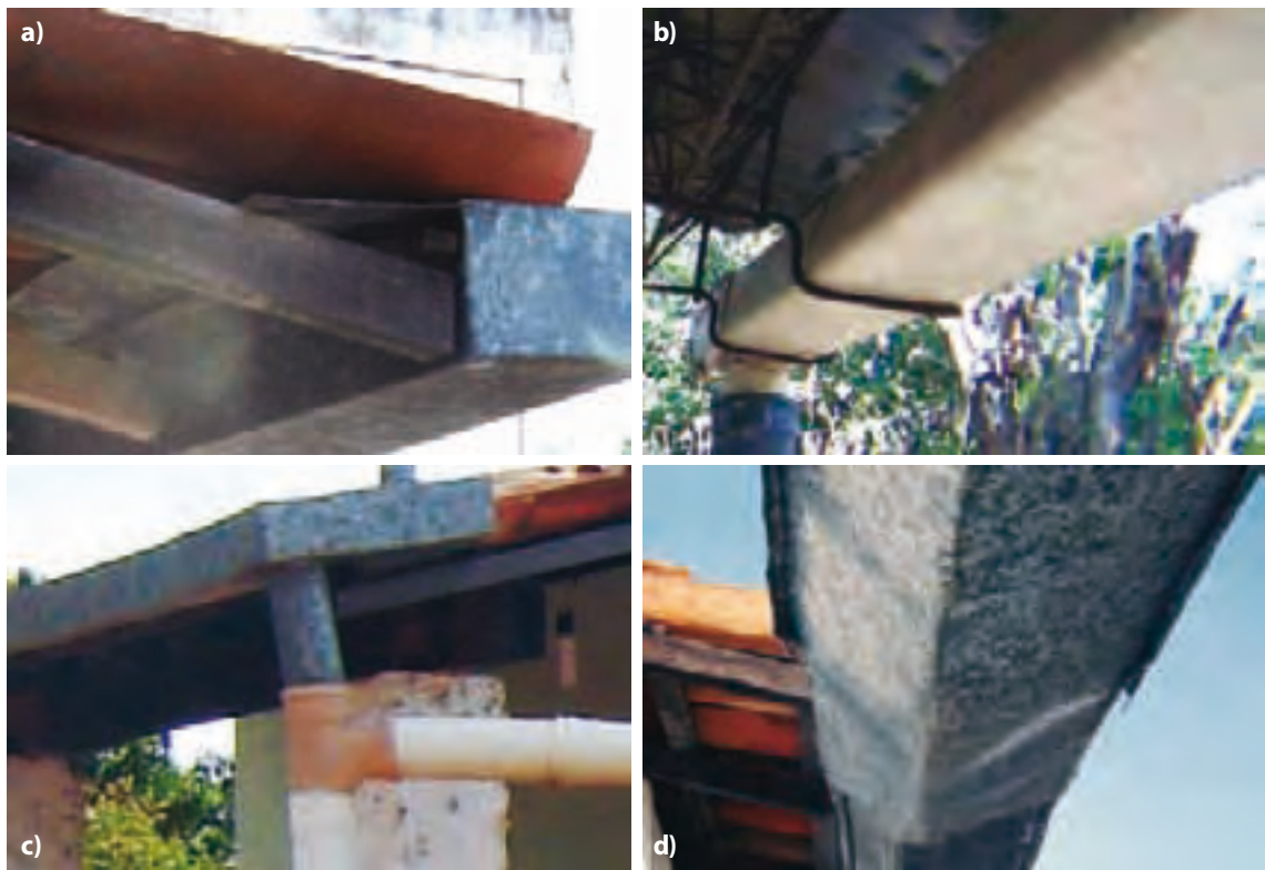
FIGURA 14-II: Formas y materiales de canaletas para recolección y conducción de la escorrentía del techo.
