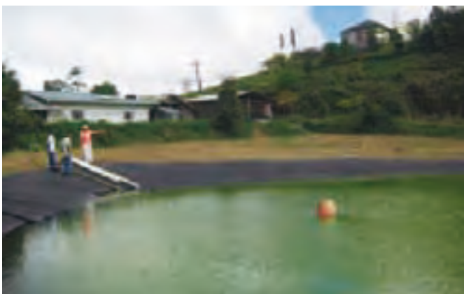
FIGURA 17-XV: Estanque excavado de almacenamiento de agua revestido con una manta de material sintético PPL-24 (polietileno reforzado de 24 mil, con 5 capas: 3 de baja densidad y 2 de alta densidad intermedia).
