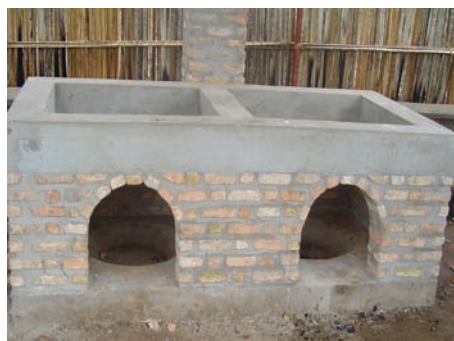
PHOTO 34 Élévation de l'ensemble des parois par rangées successives de briques, construction des cloisons de séparation des compartiments et chaînage supérieur
