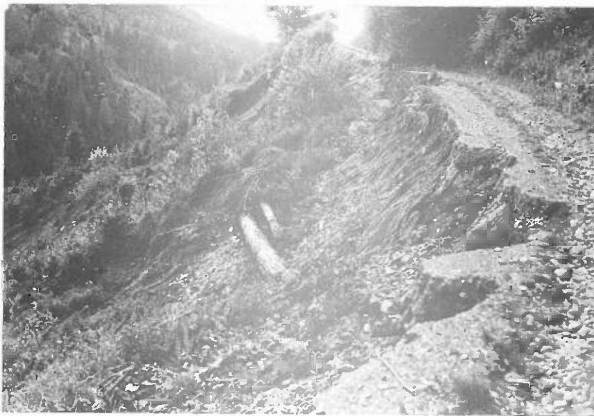
L'absence totale d'un système de drainage des eaux de surface de la chaussée résulte en glissement de terrain et ravinement (Photo: Wildbach-u. Lawinenverbauung, Kärnten)
