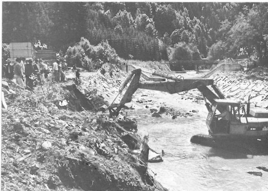
Construction d'un mur de protection des berges en pierres sèches destiné à l'entraînement. Dans le fond, barrages de retenue pour la protection d'un pont (Photo: T. Pasca)
