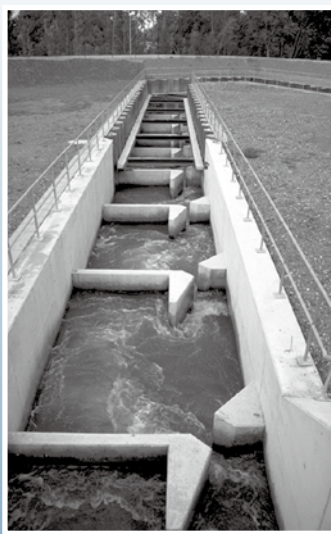
法国/德国莱茵河伊费茨海姆垂直槽过鱼道
