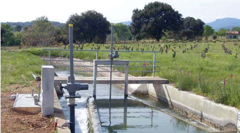
Figure 1 : Site de Lavencq :vannes motorisées
