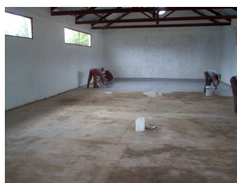
Un nouveau plancher en béton a été posé et a été revêtu de résine époxyde pour l'étanchéité aux produits chimiques
