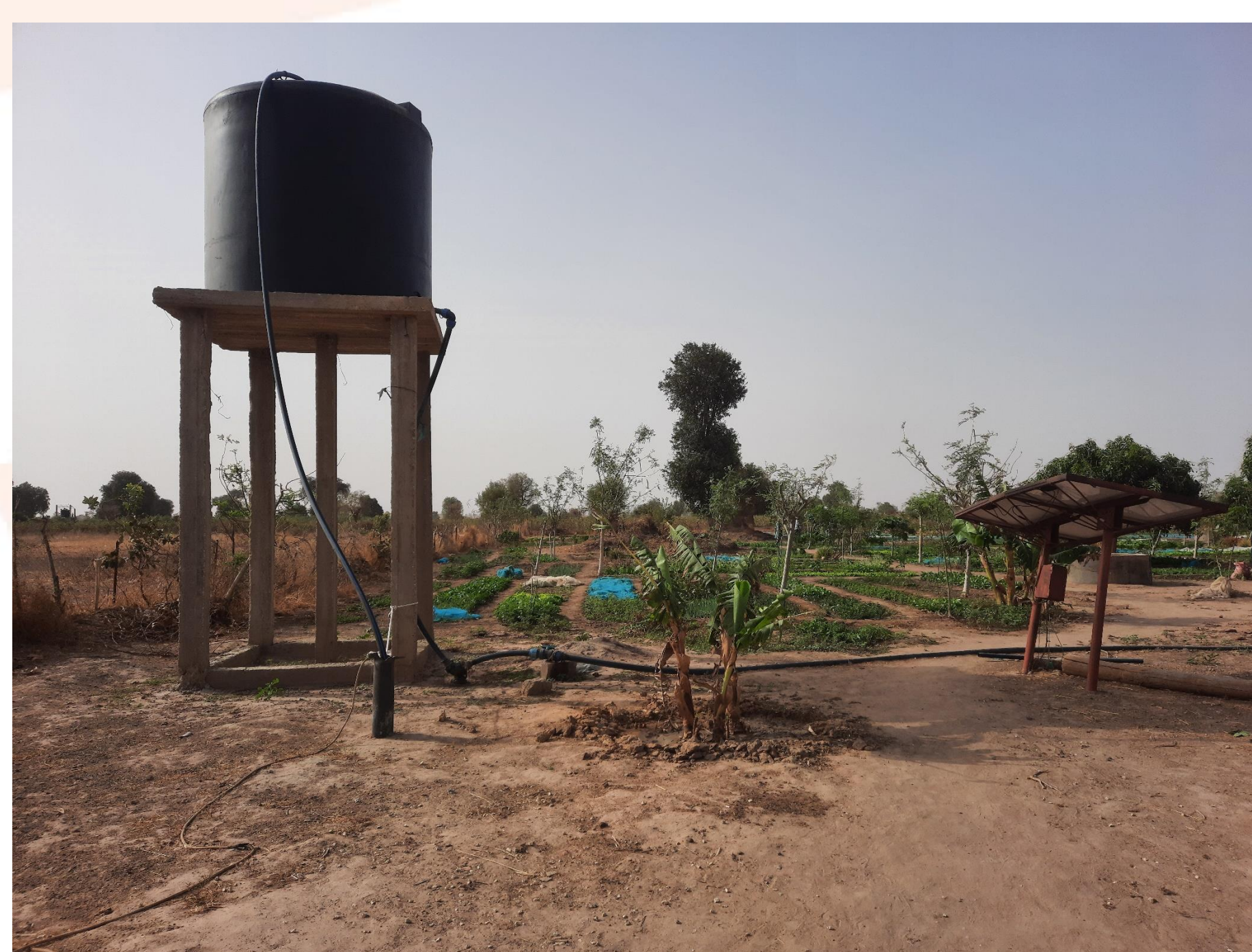
Fig. 3: Installation hydrique dans le périmètre maraîcher de Gapakh
