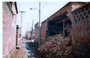
地面沉降太原晋源区农村房屋倒塌（马峻拍）
