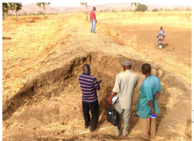
Figure N° 5 : Brèche dans la digue de ceinture à Kéniédifé
