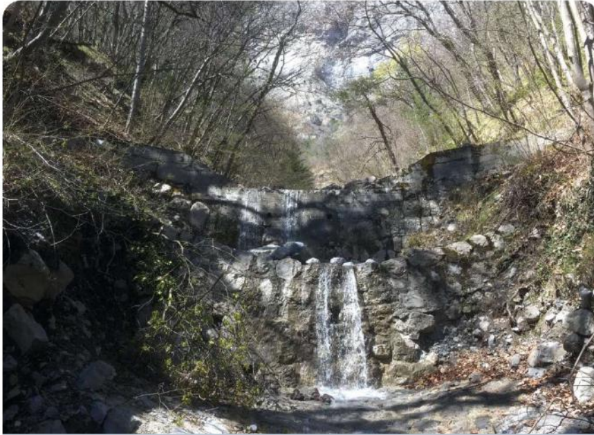
Abbildung 8: Alte und Konsolidierungswerke und forstliche Maßnahmen im Ruine- Wildbach
